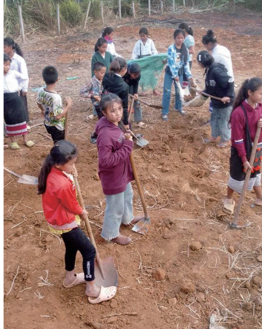
生徒たちがショベルやくわを持って、寮を建設する準備工事を手伝った=2023年3月14日
