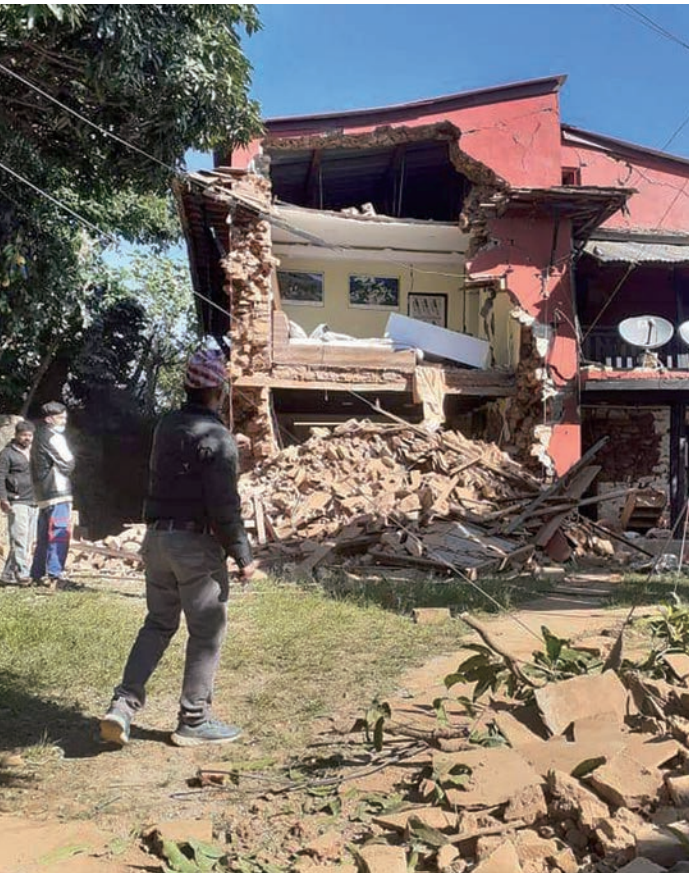
地震の揺れで壁が崩れ落ちた家＝2023年11月5日、ネパール、ジャジャルコット
